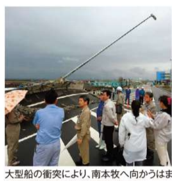
大型船の衝突により、南本牧へ向かうはま道路の橋梁が大きく損壊しました。
